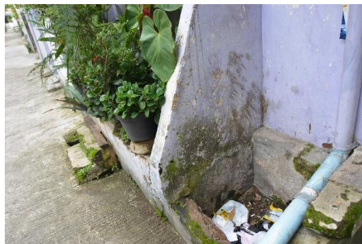
▲ごみが捨てられている様子
