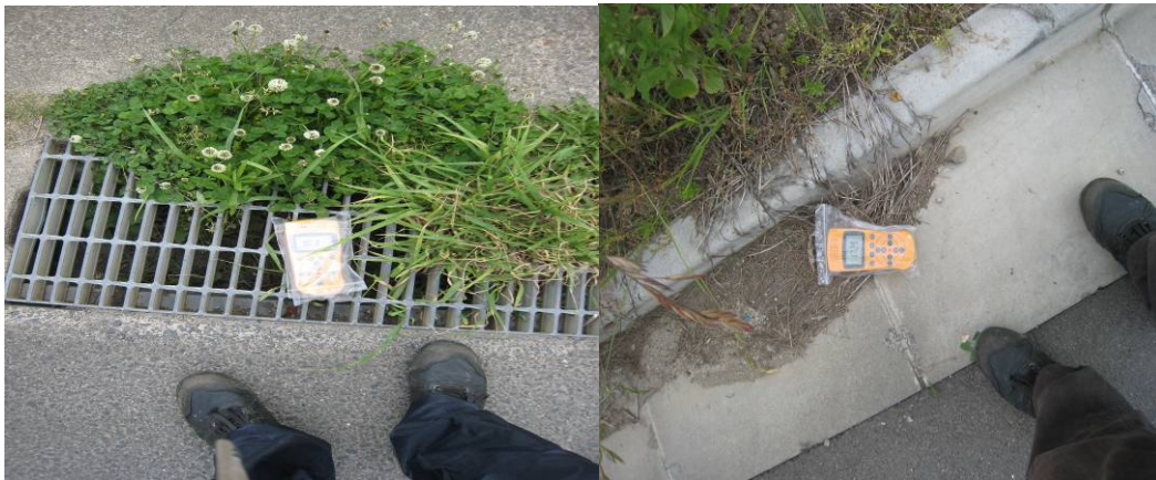
写真5 土砂の堆積した側溝
